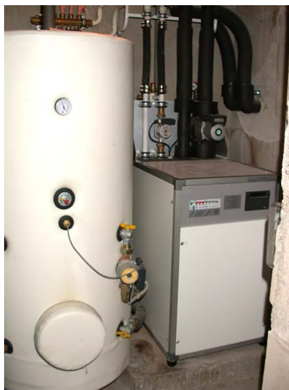
La pompe à chaleur et le chauffe-eau de 500 litres ont pris la place de la chaudière à mazout.
